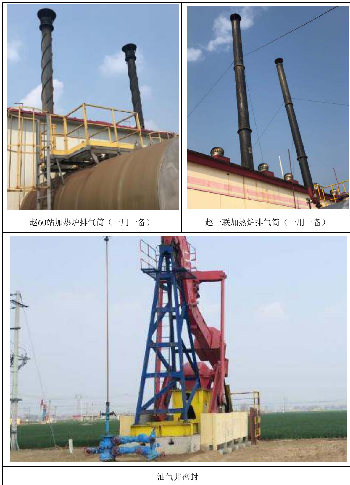
图5-3 废气环保治理设施
